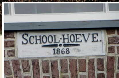
De steen ingemetseld boven de voordeur. (Foto H. Meerbeek, 20-03-2022)
